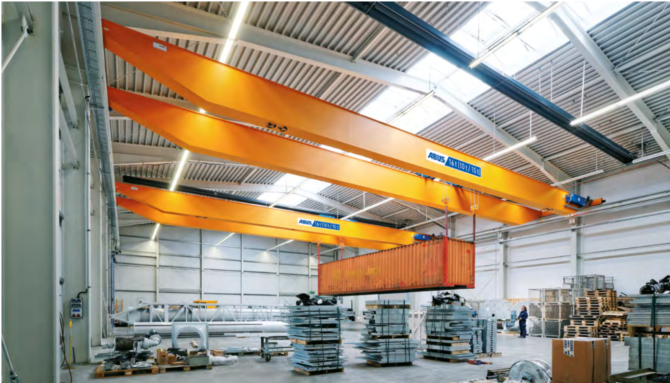
Pour le transport de marchandises longues et encombrantes, deux ponts roulants fonctionnant en tandem assurent la manutention des charges sans risque
