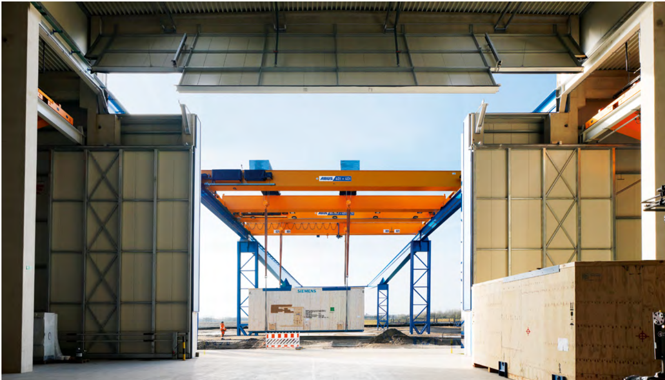
En cas de translation à l'extérieur du bâtiment, une commande fonctionnant via le pont roulant assure la commande du verrouillage du clapet de passage du pont
