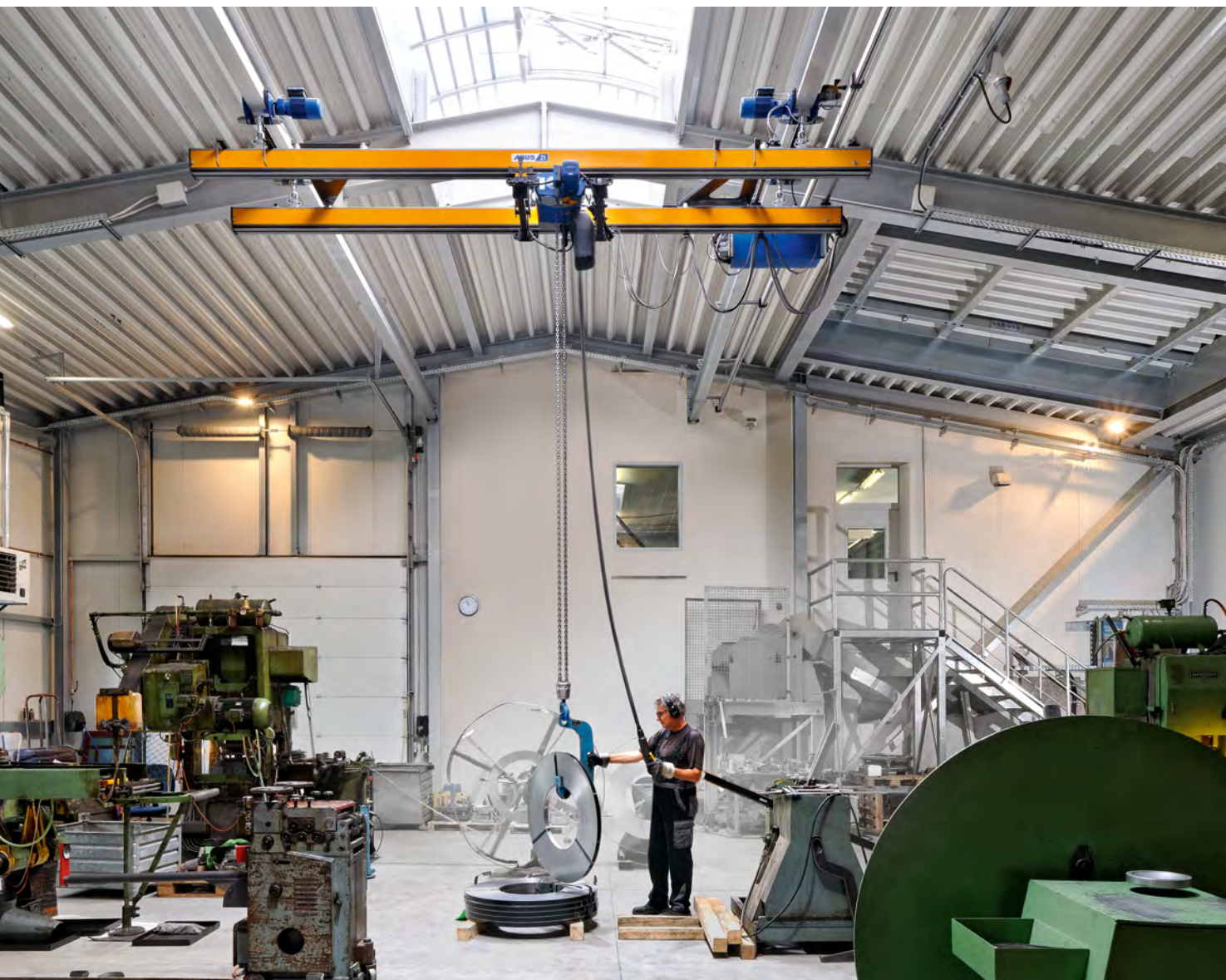
Déplaçable par chariots de translation électriques sur poutrelle en acier
